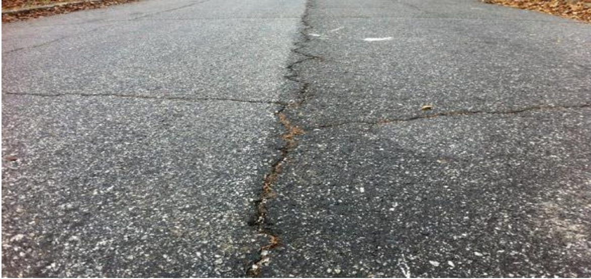
Longitudinal (Linear) Cracking
