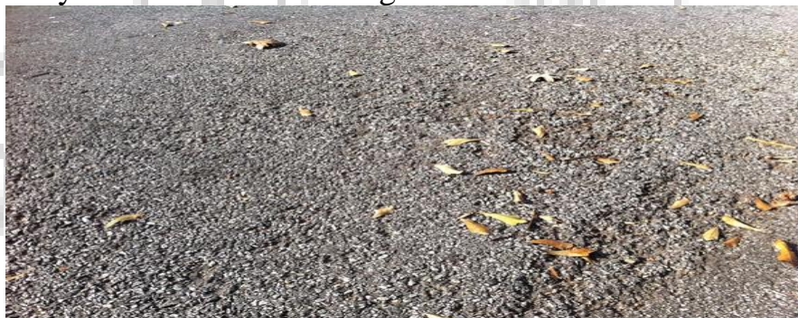
Fig. Raveling (very porous asphalt)
