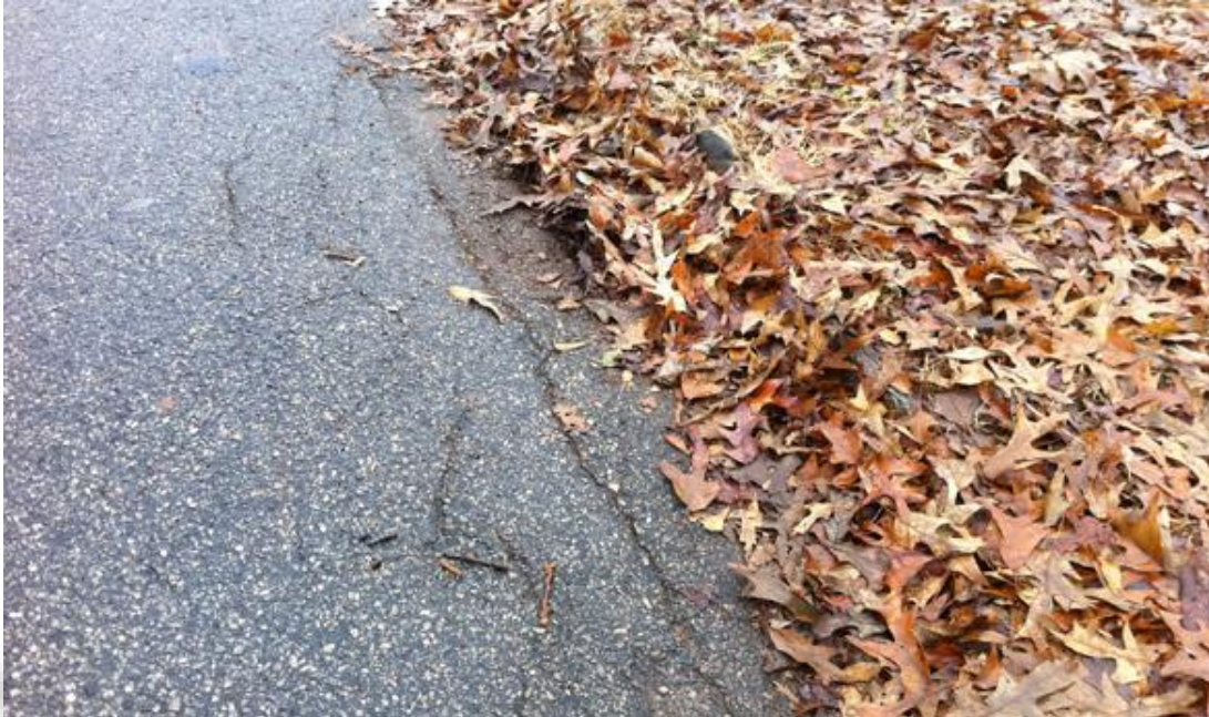
Fig. Edge Cracks
